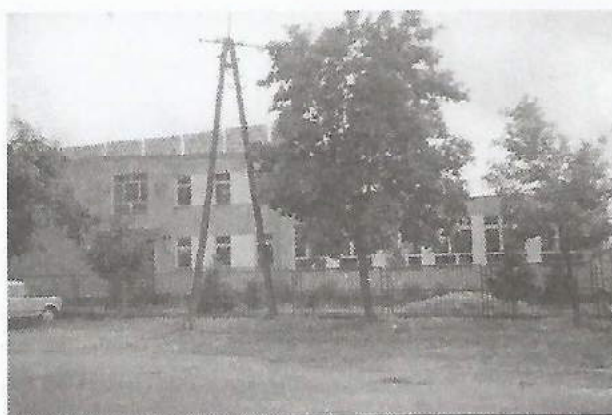
Fragmenty zbrojenia ścian widoczne od ulicy Sienkiewicza. Okna pierwszego piętra „nowej szkoły” pokazują, jak mizerny jest stan ponad 30-letniego budynku (parter już ma nowe okna).
