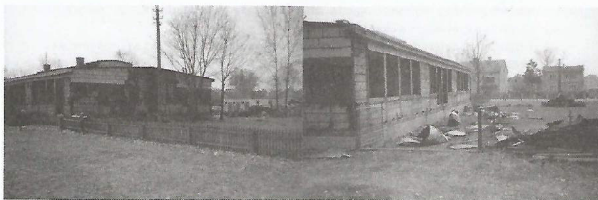
fot. 3 Spustoszenie wywołane pożarem widać dopiero od strony boiska.
